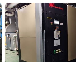
汰換高能耗空壓機
